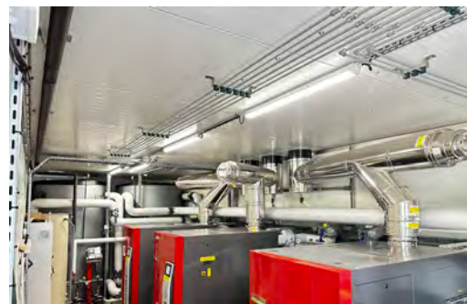
3 chaudières de 230kW chacune alimentant le réseau de chaleur
