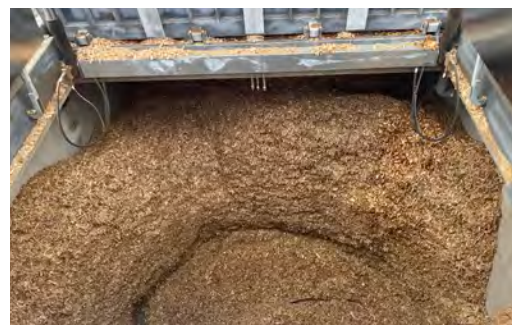
Silo de plaquettes forestières de 120 m³
